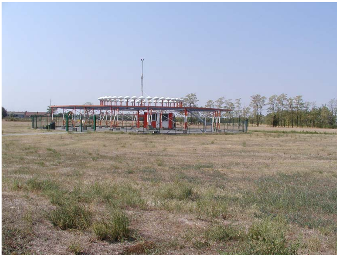
Foto 2: vista dell'antenna VOR all'interno del sito.
