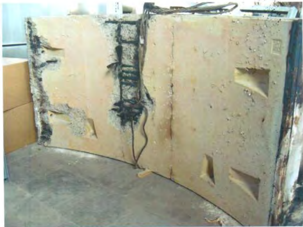
Рис. 8. Опытный образец № 2 после вскрытия защитного слоя бетона в зоне образования поперечной трещины. Полное выгорание связующих компонентов арматуры нижней зоны
